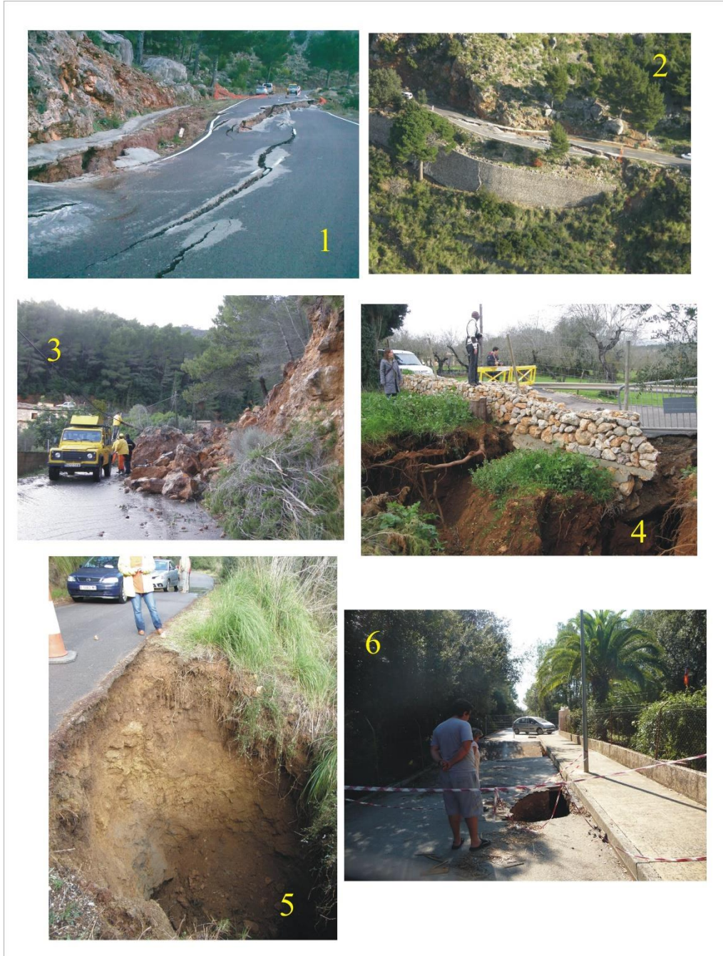
Figura 3. Fotografías de carreteras secundarias de la Serra afectadas por deslizamientos, desprendimientos y colapsos kársticos. 1 y 2) Deslizamiento de Cala Tuent (15/12/2008), 3) Desprendimiento de Es Verger (15/12/2008), 4) Hundimiento de Búger (enero 2010), 5) Hundimiento de Es Verger (15/12/2008) y 6) Hundimiento de Crestatx (3/5/2010)
