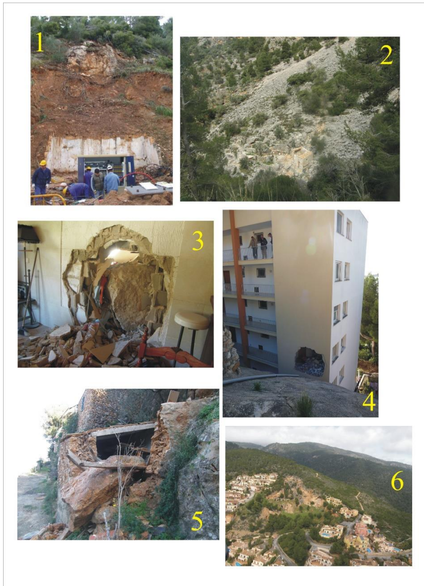
Figura 4. Daños causados en edificios, viviendas y otras edificaciones por movimientos de ladera durante 2008-2010. 1) Central de Deià (29/10/2008), 2) Biniaraix (6/01/2009), 3) Puigpunyent (14/09/2009), 4) Siesta (8/01/2009), 5) Son Albertí (Ene 2010) y 6) Costa d'en Blanes (Ene 2010)
